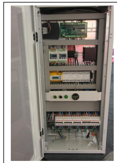
Ecocoach Batteriespeicher geöffnet
