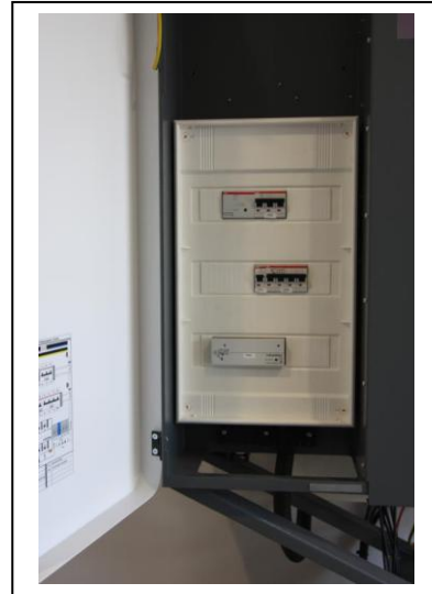
E3/DC Hauskraftwerk geöffnet
