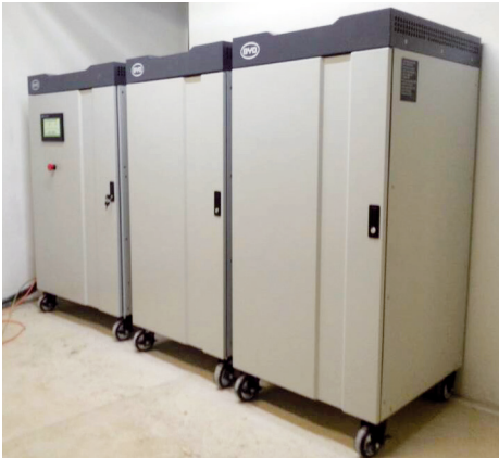
Lithium-Ionen-Speicher – Aufstellungssituation und Innenansicht (Quelle: FENECON GmbH & Co. KG).
