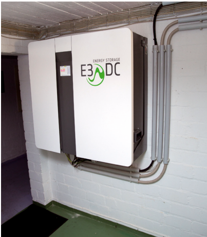
Kompaktgerät als Wandmontage im Keller (linkes Bild: DZ-4 GmbH) oder als Standgerät im Hauswirtschaftsraum (rechtes Bild: E3/DC GmbH); Akkumulatoren, Leistungs- und Steuerelektronik sind im Gehäuse untergebracht.
